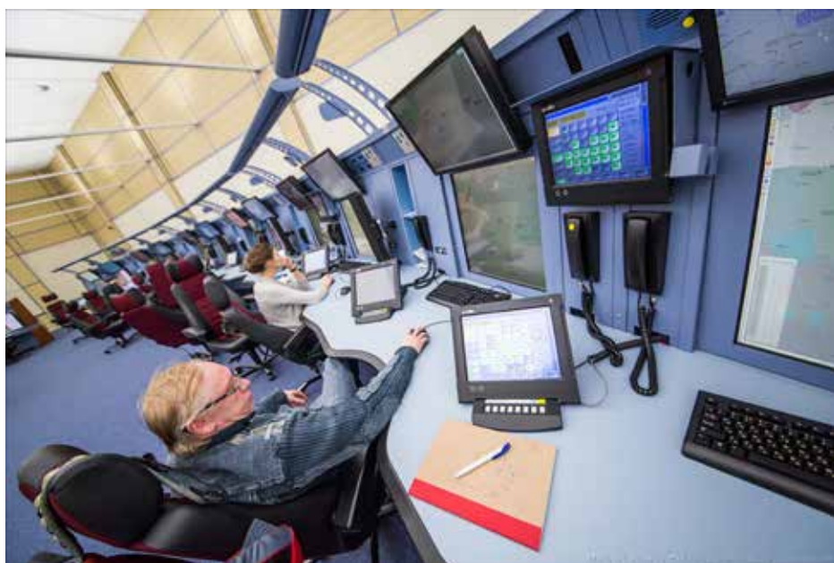
Рис. 2. Центр управления воздушным движением во Внуково.
