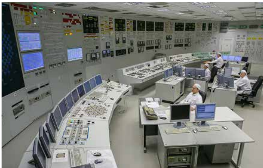
Рис. 3. Центр управления Ленинградской АЭС.
